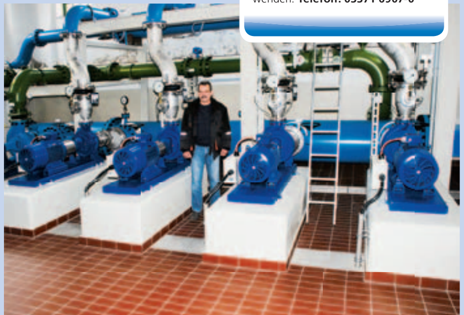
NUWAB-Mitarbeiter Jürgen Roggenbuck im Technikzentrum des Wasserwerkes Luckenwalde. Die vier Pumpen wurden nach 18-jähriger Laufzeit Anfang 2012 erneuert. Die neuen Geräte arbeiten nun noch energieeffizienter.
